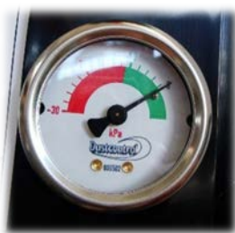
Manometro che indica quando pulire i filtri
