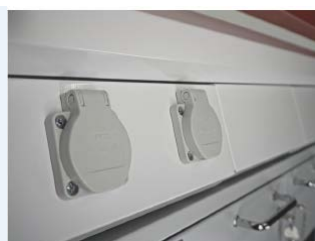
Pannello frontale sotto piano per utenze e prese elettriche
