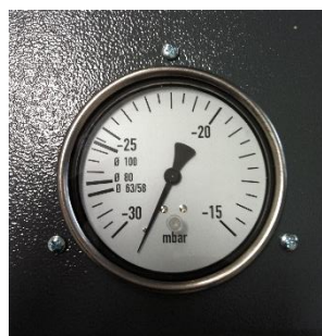
Manometro che indica quanto effettuare la pulizia
